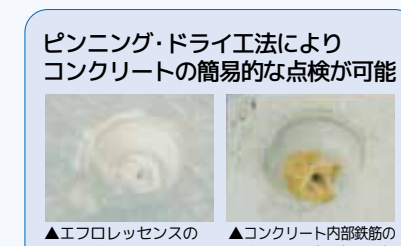
▲エフロレッセンスの発生状況 ▲コンクリート内部鉄筋の錆汁による赤褐色化現象
