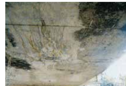
■コンクリートの劣化が目立つ床版下面
