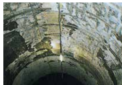
■水がしみ出ているトンネル内の様子
